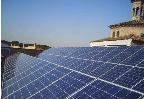
Instalación fotovoltaica Poble Espanyol Montjuïc- Bcn.
