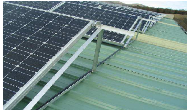
Instalación fotovoltaica sobre cubierta 100 kW prov.Barcelona
